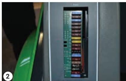
Bezpieczniki – podłoga kabiny, strona prawa
